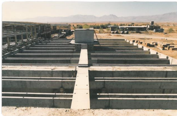
تصفیه خانه آب مجتمع صنایع رزین شهر
